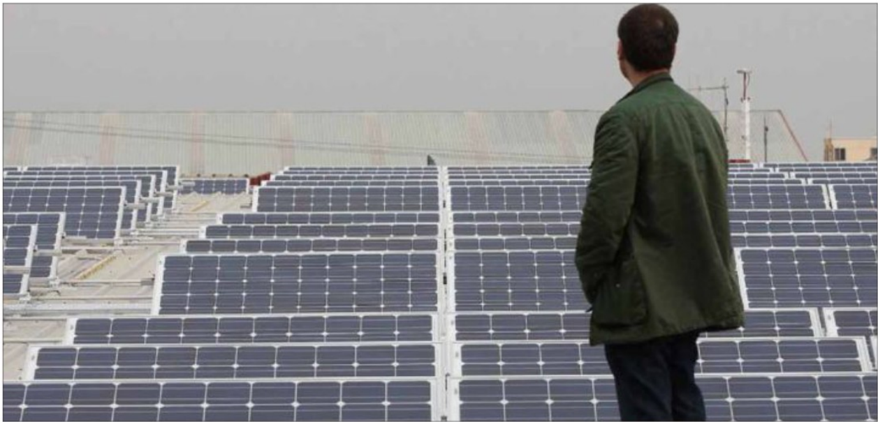
Instalaciones fotovoltaicas construidas sobre la cubierta de las cocheras de Auvasa, financiadas con fondos del Plan E. / J. M. LOSTAU
