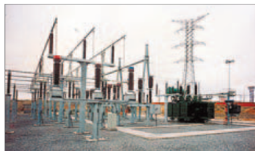
Imagen de un tendido eléctrico.
